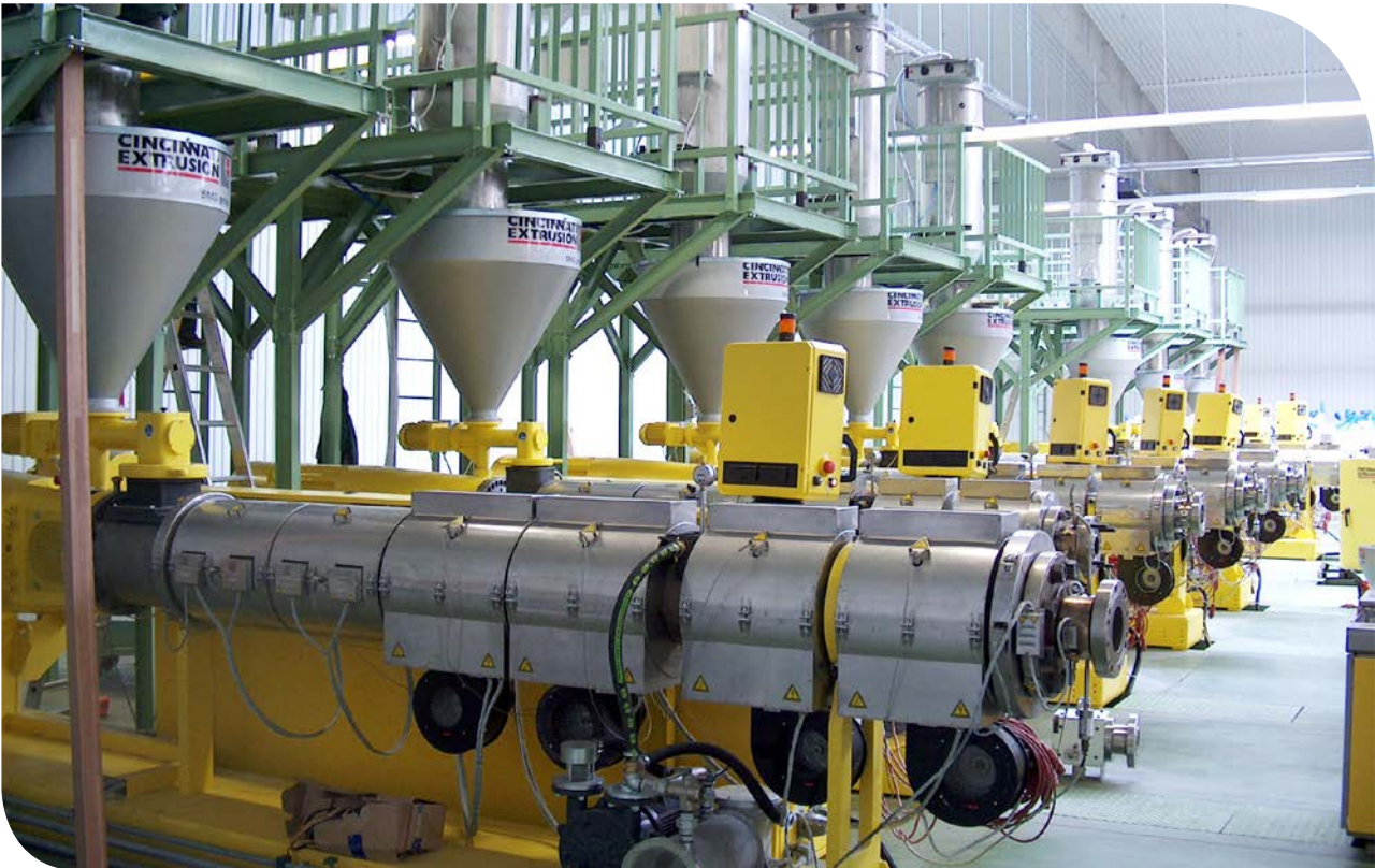
Machines d'extrusion des profilés PVC
